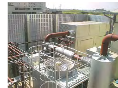
2012年から、天然ガスを利用した環境にやさしいコージェネレーションシステムを稼働
