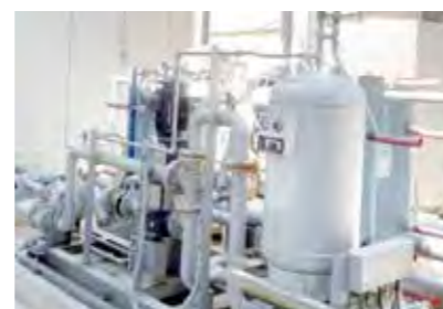
群馬工場では、天然ガスを利用した環境にやさしいコージェネレーションシステムを稼働 From Gunma factory, I operate an eco-friendly cogeneration system using natural gas
